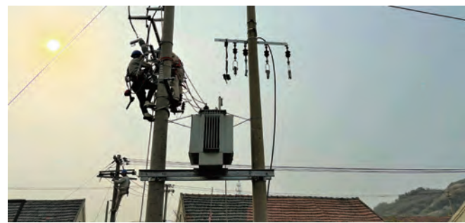
为提高供电可靠性,让居民用上安全、稳定、舒心的电,供电工程分公司徐南供电所精心调研、统筹规划、科学部署,组织人员对连云区板桥镇10千伏板桥线居民区虹片变进行变压器增容改造。(周国成)
